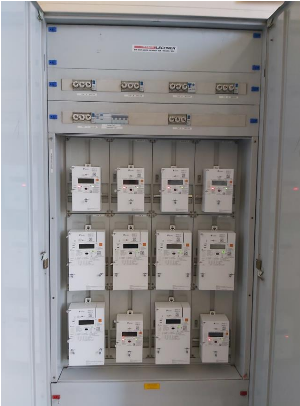
Der Zählerschrank im Erdgeschoß ist voll belegt – ein separater Zählerschrank für die Volleinspeisung ist im Keller zu installieren
