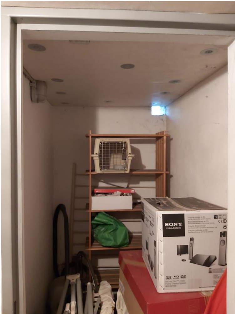
Raum im Keller (fast direkt unter dem Zählerschrank im Erdgeschoss situiert) Rechts oben im Bild – Verlegemöglichkeit für die DC-Leitungen in den Kellerraum Im Kellerraum soll installiert werden: Speicher
