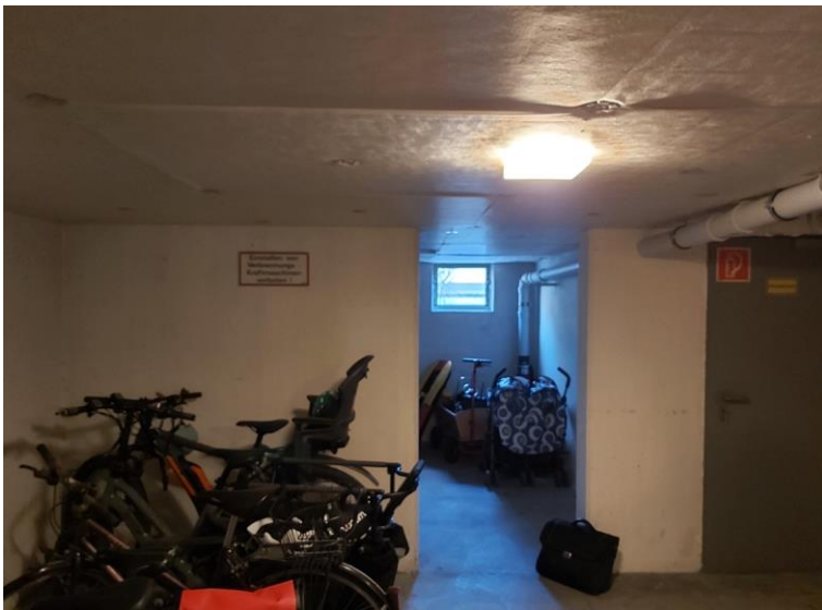
Raum vor dem Kellerraum/Speicherraum – an der linken Wand Montage von Wechselrichter mit Überspannungsschutz, Zählerschrank (Volleinspeisung)
